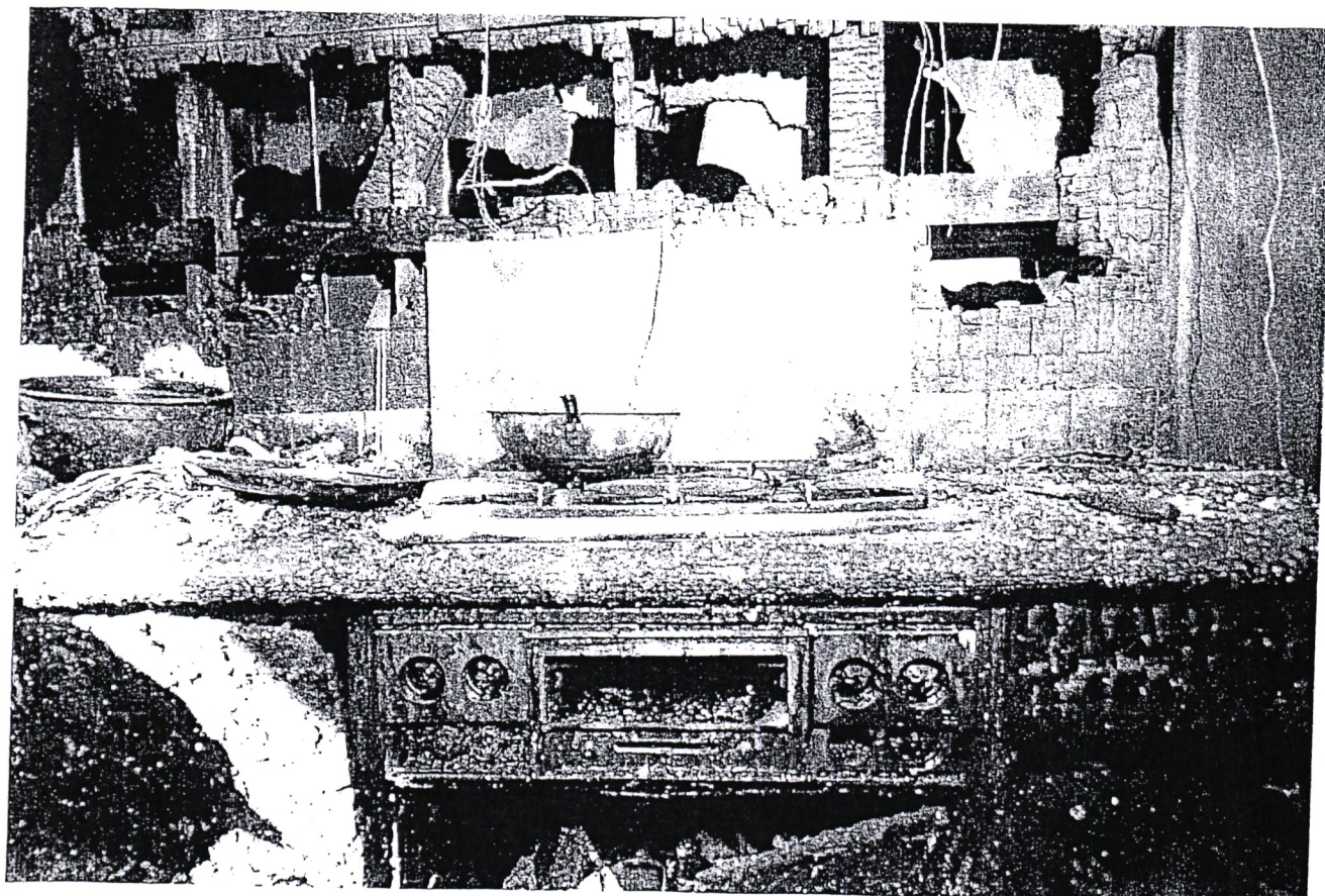
4口ガステーブルのスイッチ部付近の焼損状況
